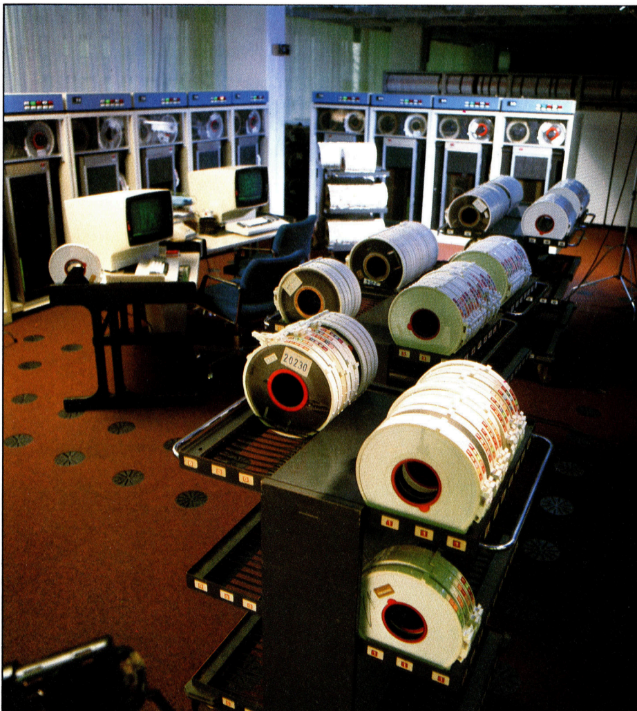
Blick in ein Rechenzentrum: Daten über Daten auf Magnetbändern.
